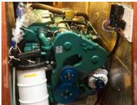
Volvo MD 22 med 150 A Balmar generator. Generatortills reglarenhet, säkringar mm sitter på skottet till höger, ovanför generatortill
