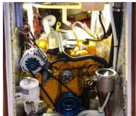
Ny Vetus motor med två generatortill. Gul originalgeneratortill till höger och vit Balmar till vänster
